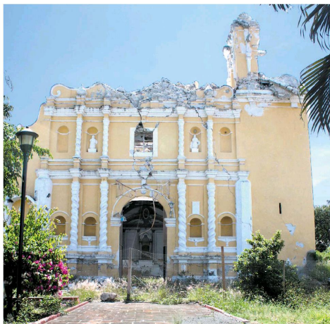
La iglesia de Santiago Apóstol, construida en el siglo XVII, se encuentra casi destruida. BIBIANA DIAZ
